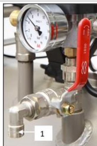
Rys. 8: Podłączanie do wylotu sprężonego powietrza
