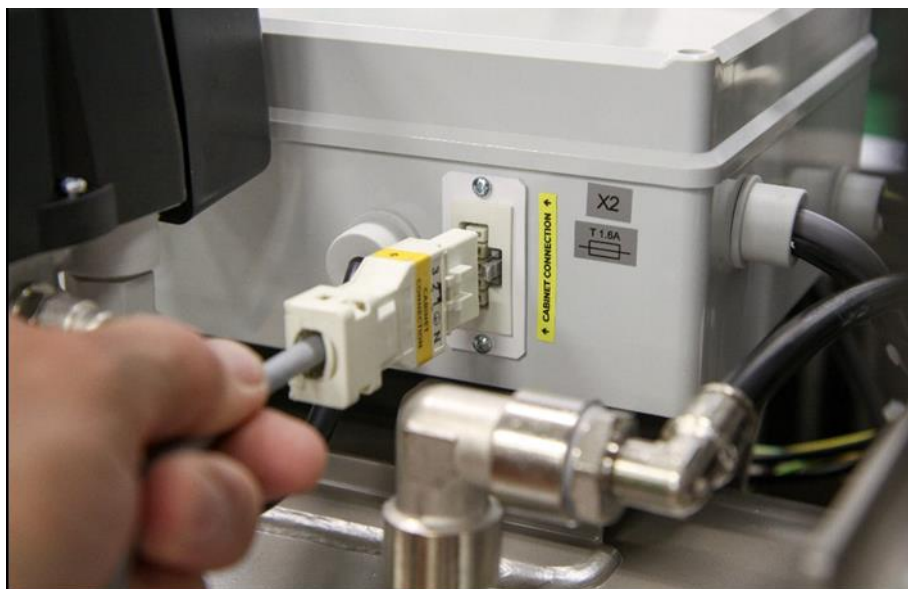
Obr. 13: Zapojenie skrinky ku kompresoru
