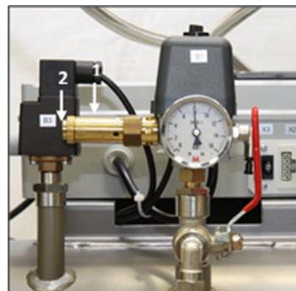
Рис. 17: Проверка предохранительного клапана
