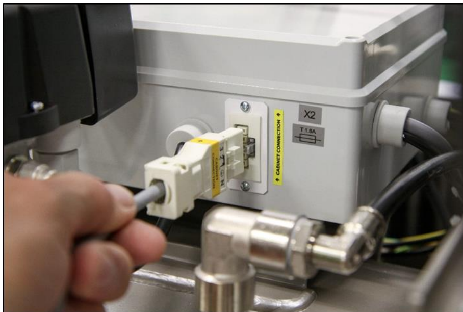
Obr. 13: Zapojenie skrinky ku kompresoru
