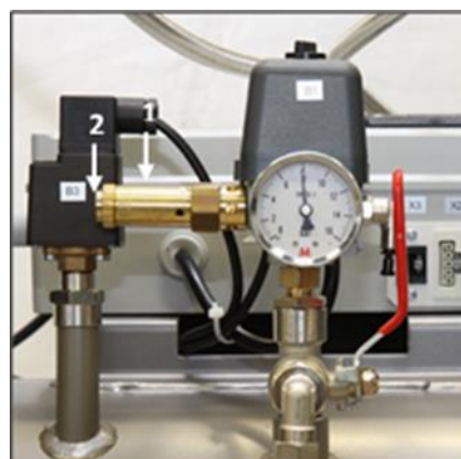
Рис. 25: Проверка предохранительного клапана
